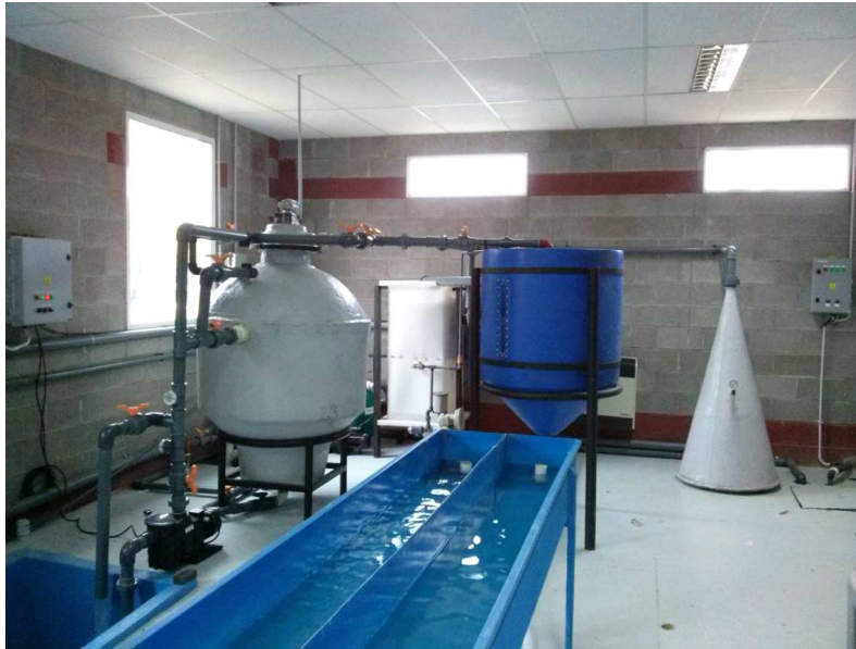
Estación de Piscicultura Isla Pavón
